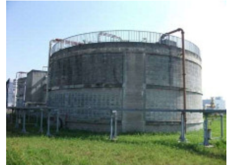
(豊川浄化センター：PFIで再稼働するメタン発酵施設)
