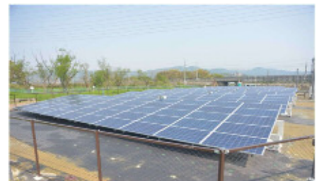
(豊清町太陽光発電所)
