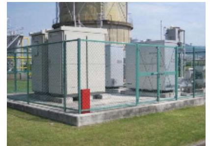
(蒲郡市下水道浄化センター 消化ガス利用コージェネレーション施設)
